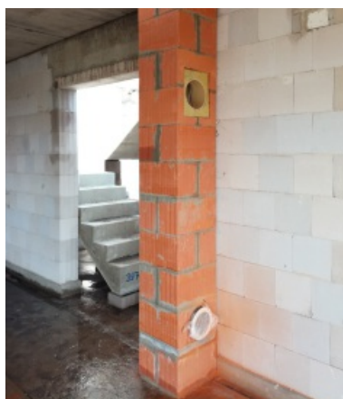
Příprava na přívod vzduchu z boku
