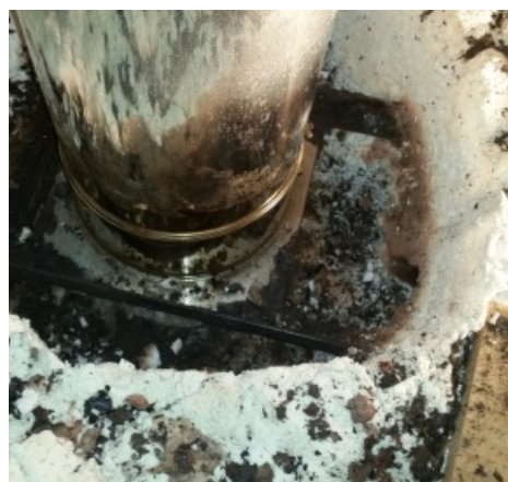
Následek chybně zaizolovaného prostupu komínu stropem
