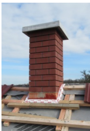
Bezpečný vstup komína střešní konstrukcí
