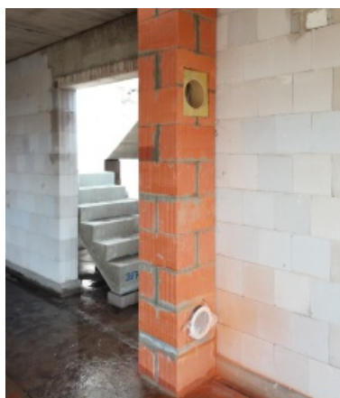
Příprava na přívod vzduchu z boku
