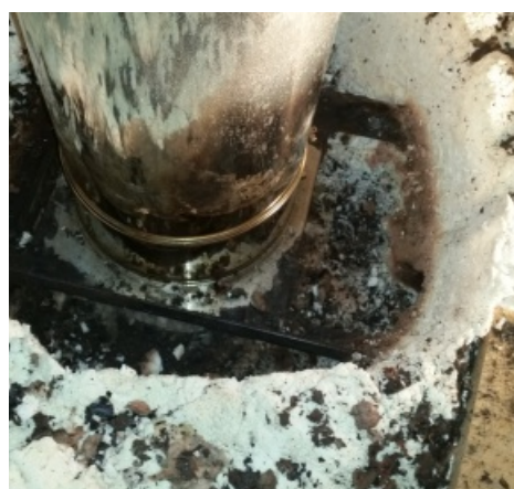
Následek chybně zaizolovaného prostupu komínu stropem
