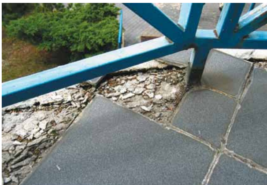
Obr. 2: Poškozené provozní souvrství balkónu u sloupku zábradlí
